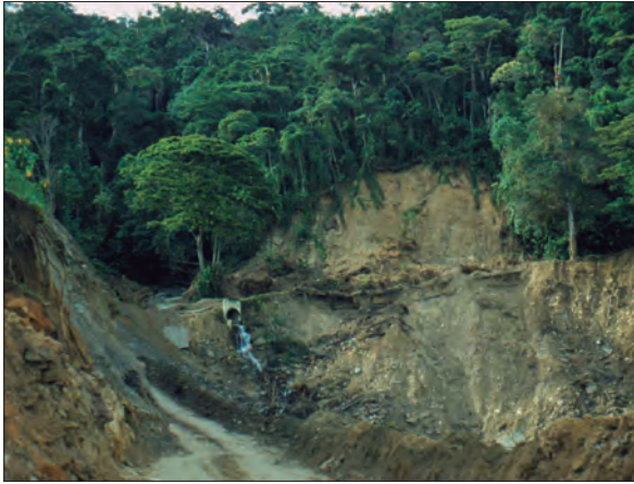
Figura 7: Carretera Boca de Tigre-Macuto, vertiente norte, arriba de la Hacienda. La pendiente desestabilizada por la carretera causó el derrumbe. 29-1-2000. Aproximadamente seis semanas después la catástrofe.
