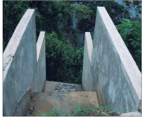
Figura 8: Carretera Caracas-Galipán, vertiente sur: Los Asientos. Desagüe conduciendo el agua hacia el bosque sin estructuras de disipar la energía cinética del agua. Lecciones no aprendidas, 11-8-2002. 1.700-1.900 m.
